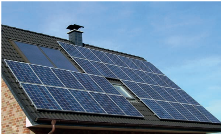
Rycina. 1. Typowa instalacja solarna na budynku jednorodzinnym
